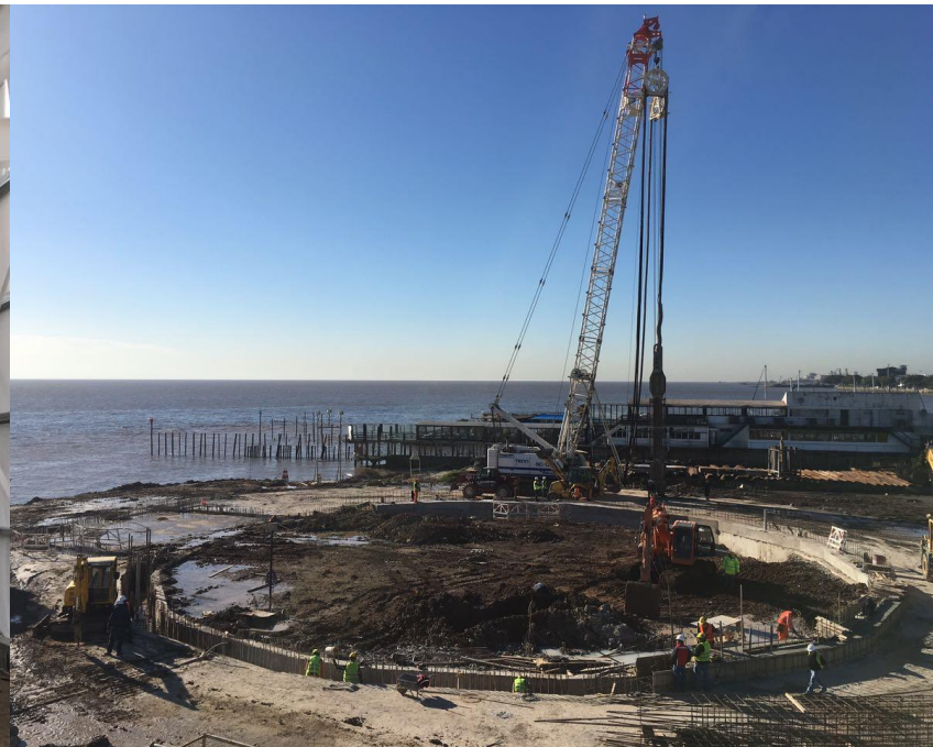
Pozo de Descarga
